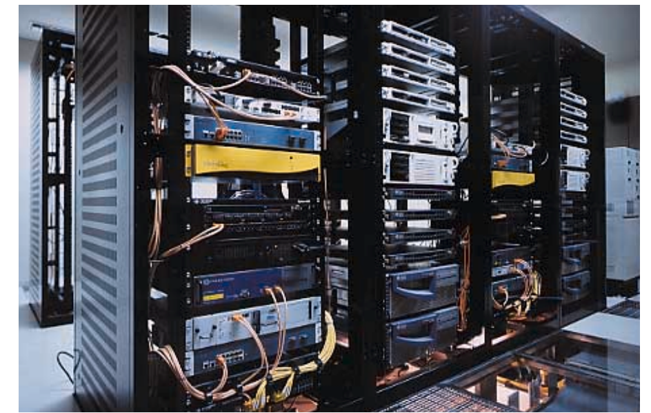
NTTデータがiDCサービスの1つとして提供する技術評価サービス「ベンチマークセンタ」の施設内風景
