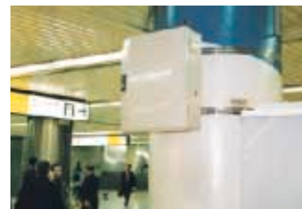
無線LANサービス提供のための関連機器を納めたボックス。ホットスポット脇の柱に備え付けてある。周囲半径約30~40Mのエリアをカバーしている
